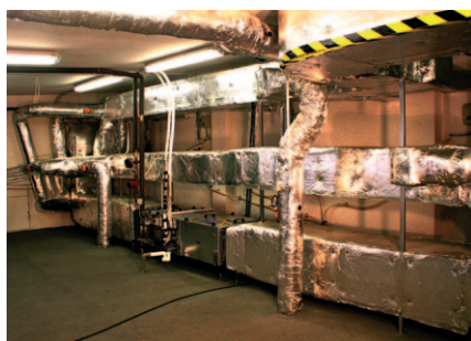
■ VZT jednotka s rozvody je klíčovým prvkem pro klimatizaci, větrání a udržování podtlaku v kójkách.
